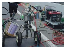
⑥注入ポンプ
