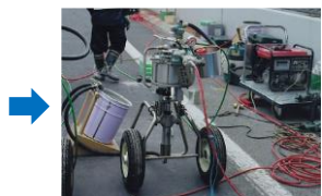
⑥注入ポンプ
