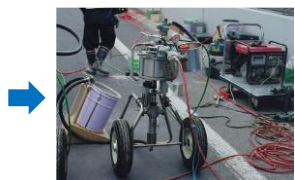
⑥注入ポンプ
