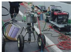
⑥注入ポンプ
