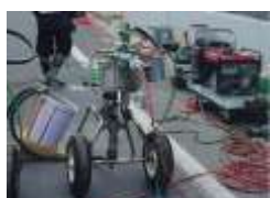
⑥注入ポンプ
