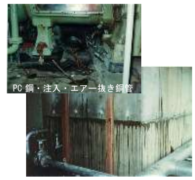
PC 鋼・注入・エア抜き銅管 コンプレッサ基礎貫通亀裂と打継ぎよりアルファテック 370 流出
