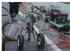
⑥注入ポンプ
