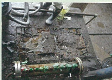
既設セメントグラウトの油濁劣化
