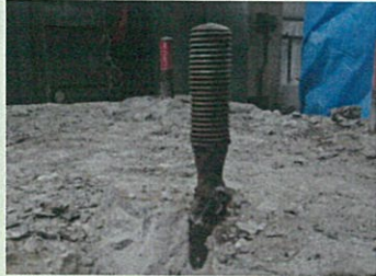
機械撤去後のアンカーボルトは錆と振動による摩擦で痩せていた
