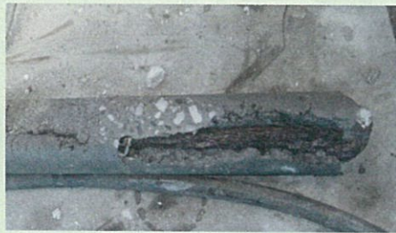
コア抜きしたアンカーボルトは腐食していた
