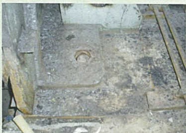
脚部のアンカー破損
