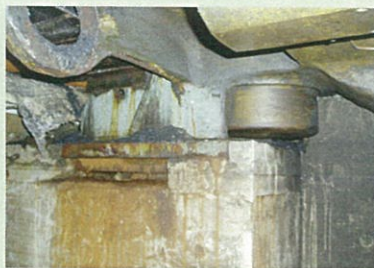
ベース廻りのグラウトが脱落
